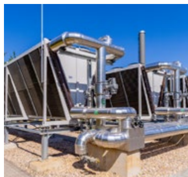
Ein Teil der neuen iKWK-Anlage in Gotha-Siebleben (Foto: Sabine Wroblewski-Freund)
